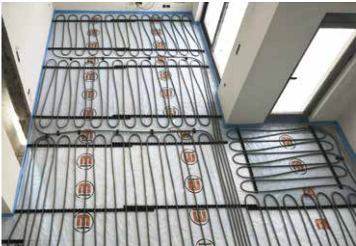
Τοποθέτηση ενδοδαπέδιας θέρμανσης σε διαμέρισμα AXIACON / Heating floor installation on AXIACON apartment.
